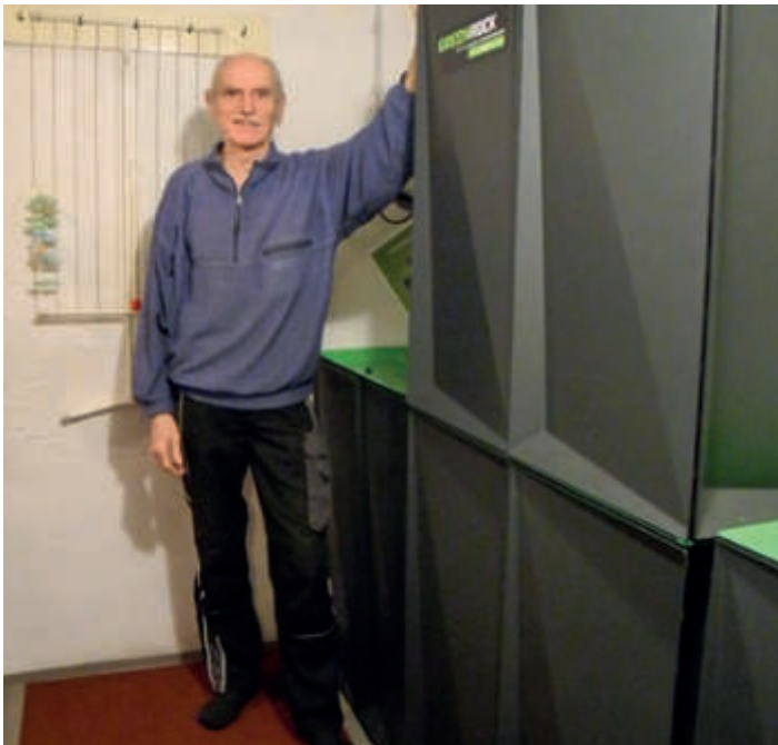
Der Salzwasser-Batteriespeicher (7,5 Kwh -Anlage 3-phasig) speichert den Strom aus der Photovoltaik-Anlage
